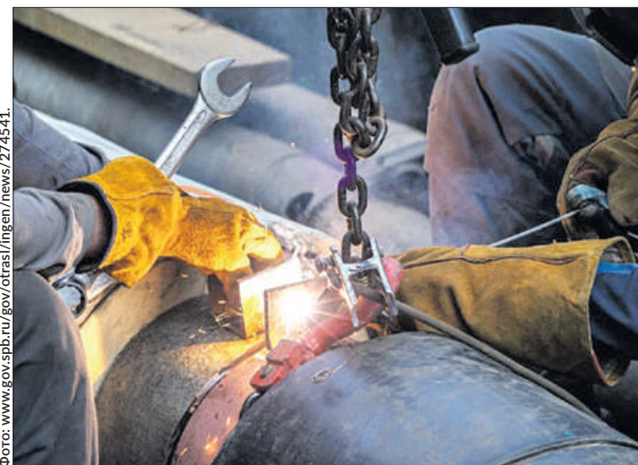
В условиях плотной жилой застройки специалисты монтировали участки временного и основного трубопроводов параллельно.
